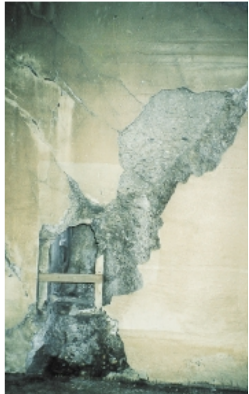
Abb. 12: Massive Risse und Druckschäden im Belchentunnel. Breite des Lüftungseinlasses ca. 30 cm.
