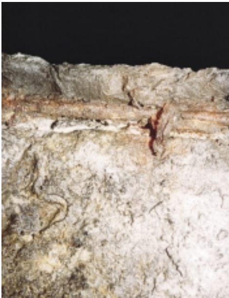
Abb. 3: km 1030: Aufkonzentration des Kalzium- und Magnesiumsulfats hinter der Spritzbetonschale an der Kontaktzone zwischen Fels und Gunit.
