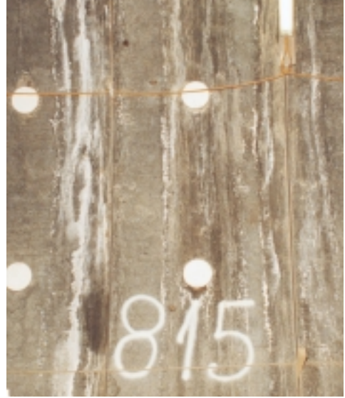
Abb. 3: N3 Bözbergtunnel Weströhre (Aufnahme 29.4.91). Tm 1017. Resultat: Natriumsulfatausscheidungen mit wenig Chlorid. Der Sulfatgehalt im Bergwasser variiert von 3350 mg/l bis zu 28'000 mg/l, Chloridgehalt immer > 1290 mg/l. Summe der gelösten Stoffe min. 7,1 g/l, max. 65 g/l.
