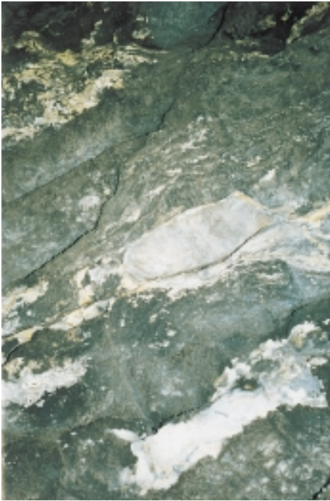
Abb. 9: Das grosse Bruchstück von Abbildung 8 löste sich an dieser Stelle im Gewölbe.
