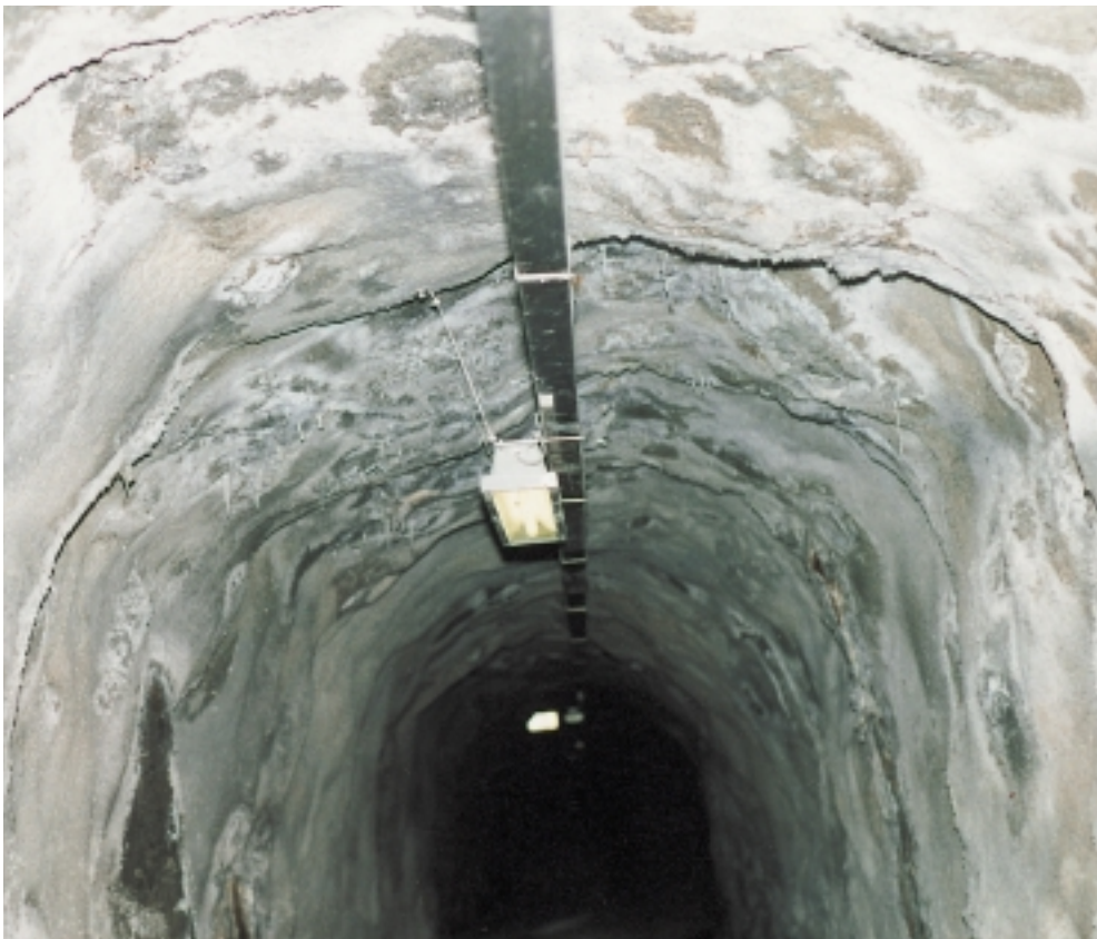
Abb. 5: Weisse Salzausblühungen auf der Innenseite der Spritzbetonauskleidung im Gotthard-Sicherheitsstollen, 20 m nördlich Querschlag 26 (km 4,850 ab Nordportal). Stärke der Verkleidung ca. 4–7 cm.
