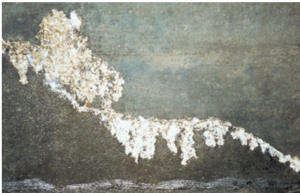
Abb. 7: Die obere Aufnahme zeigt einen Längsriss im Stollen Zervreila–Peil bei Tm 2400. Die weissen Ausscheidungen an dieser Stelle bestehen nicht nur aus Kalziumkarbonat, sondern zeigen Anteile von zersetzten Betonpartien. Dies erkennt man an den feinen Sandkörnern, die in den Versinterungen enthalten sind. Der Beton ist an dieser Stelle massiv geschädigt, und lediglich die oberste Deckschicht ist intakt geblieben.
