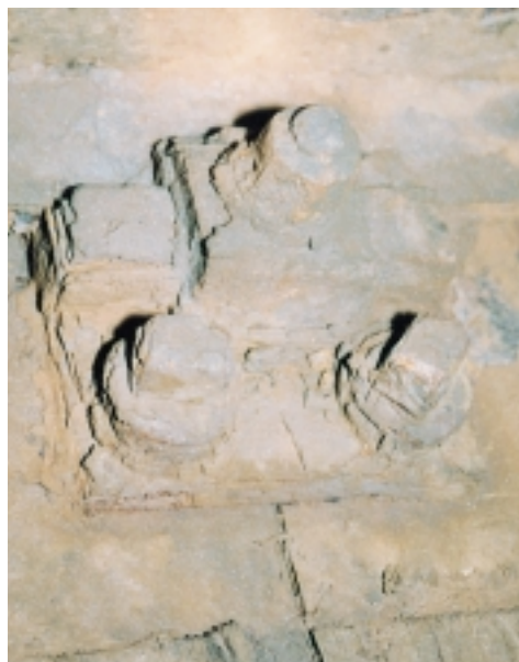
Abb. 4: Befestigungselement der Geleise im Bereich Portal St. Gallen.
