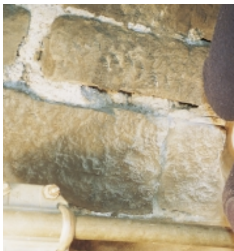
Abb. 8: Durch Salzsprengung werden die Fugen «zerrieben» und verkleinern sich stetig, bis sie im Extremfall vollständig verschwinden.
