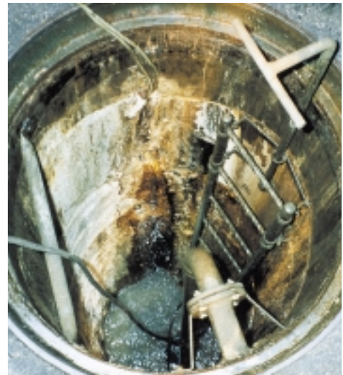
Abb. 7: Pumpenschacht eines der 28 Sickerschlitze. Das anfallende Bergwasser fließt aus der oberen Sickerleitung (Bereich Sohlbeton) zu. In periodischen Abständen wird das Bergwasser abgepumpt.
