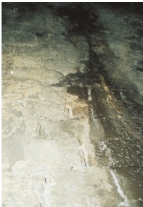
Abb. 9: Durch die Sprengzyklen (feucht – trocken) der Salzkristalle wird das Betonmauerwerk stark geschädigt. Der Versalzungsgrad des Mauerwerks inklusive der Fugen ist sehr hoch, eine tiefgreifende Reinigung fast unmöglich.
