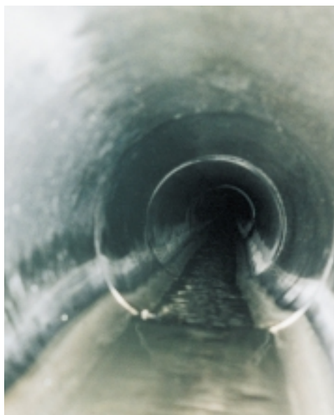
Abb. 9: Element Nr. 80 Blickrichtung Nord, Deformationen im Untergrund werden über die einzelnen Rohrabschnitte abgetragen = undichte Fugen; Absätze. Eternit-Rohr \varnothing 40 (vgl. Abb. 2).
