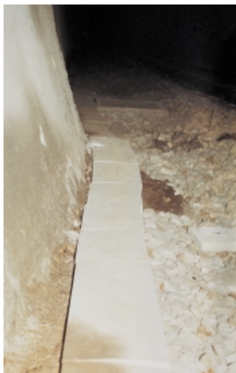
Abb. 13 km 1150: Deformierter Bereich der Spritzbetonschale über dem Widerlager mit Leitungskanal davor. Es zeigt sich, dass auch heute noch viele Druckzonen im Tunnel aktiv sind. Zonen mit Anhydrit neigen dazu, bei Wasserkontakt zu quellen. Maximales Quellvermögen ergibt sich bei 10–15% Tongehalt im Anhydrit. Die Quellvorgänge sind auch 150 Jahre nach dem Bau des Tunnels nicht restlos abgeklungen.
