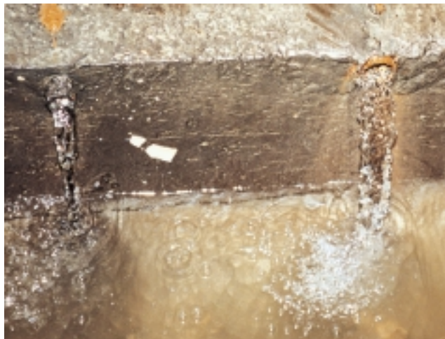
Abb. 4: Obige Aufnahme aus dem Stollen Zervreila–Peil zeigt \text{CO}_2 -haltiges Bergwasser, welches beim Eintritt in den Stollen entgast.
