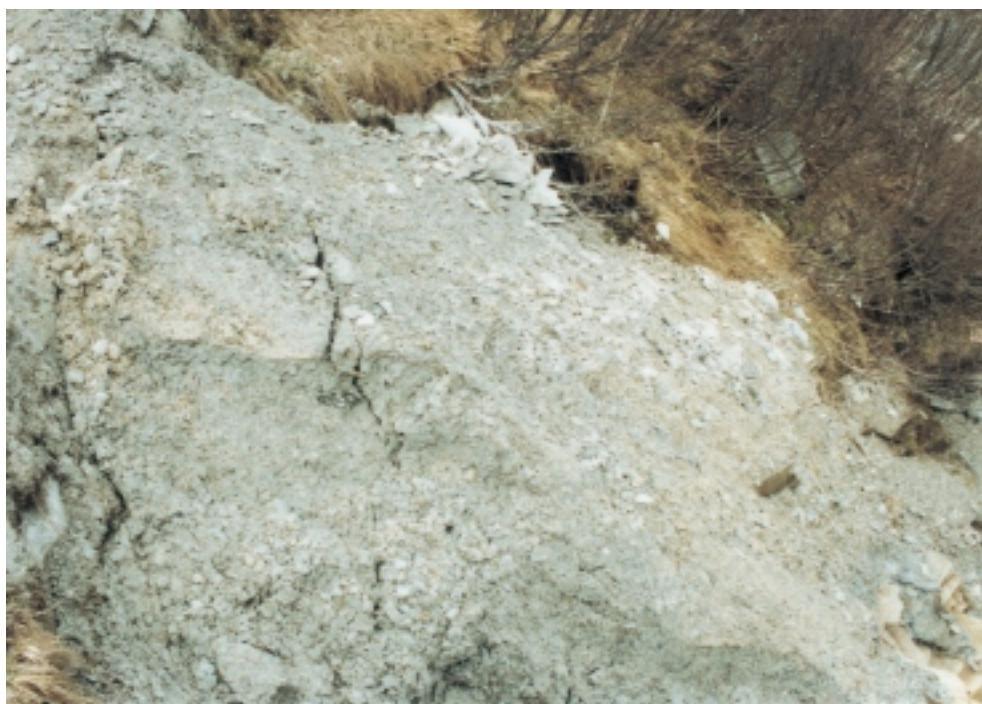
Abb. 8: Zersetzungsprodukte aus den schadhaften Stellen im Stollen.
