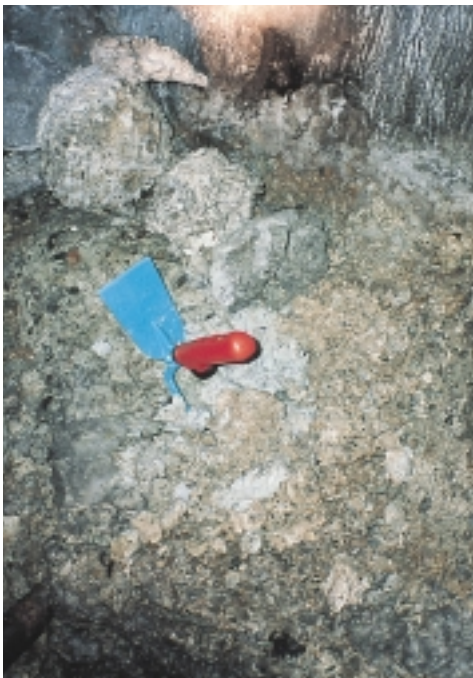
Abb. 7: Tiefgreifende Zerstörung des Betons durch Gipfstreiben (Widerlagerbereich).
