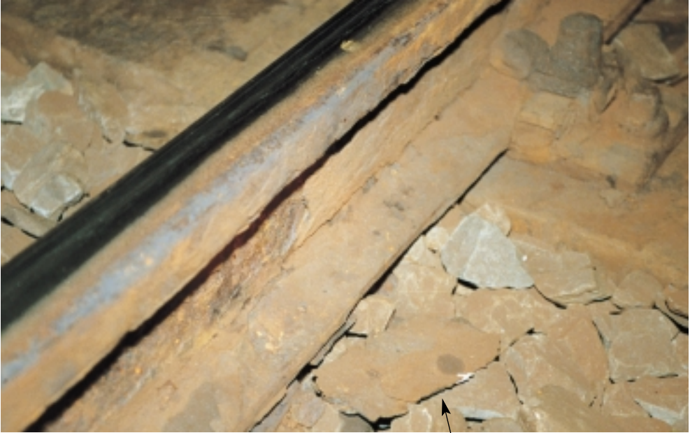
Abb. 5: Gleiskorrosion durch NaCl-haltiges Bergwasser. Die abgebrochenen Stegteile wiegen mehrere 100 Gramm.
