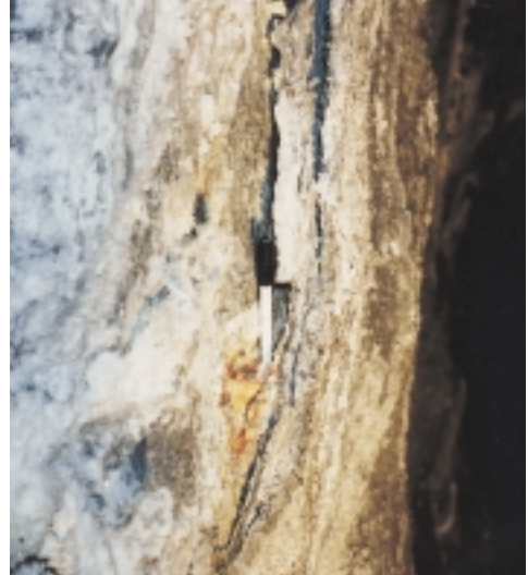
Abb. 7: Die Salze kristallisieren zwischen Fels und Spritzbeton. Durch den Platzbedarf der Kristalle entstehen Abplatzungen.
