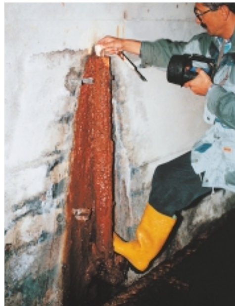
Abb. 3: Quellaustritt in den Stollen. Die roten Ablagerungen zeigen die Anwesenheit von CO 2 -haltigen Wässern an, denn nur diese vermögen Eisen im Untergrund zu lösen.
