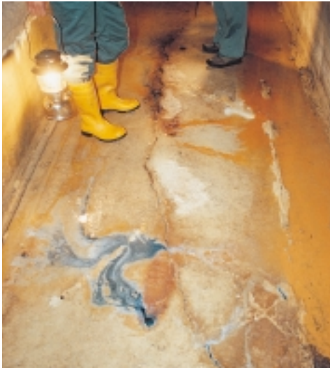
Abb. 6: Die Sohle ist gebrochen. Im Riss sichtbar sind die Betonersatzprodukte.
