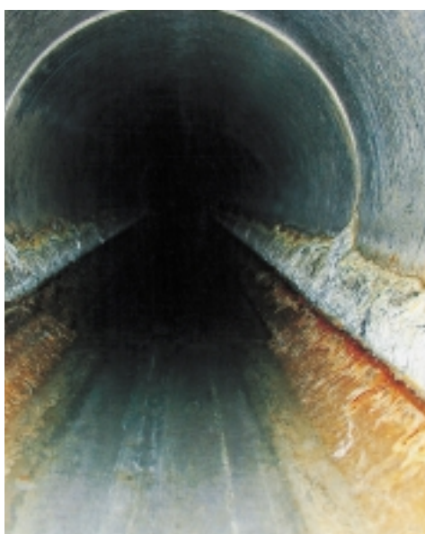
Abb. 10: Wassereintritt im Bereich von Rohrstößen, Eternit-Rohr \varnothing 40 beim Element 196, Blickrichtung Nord.
