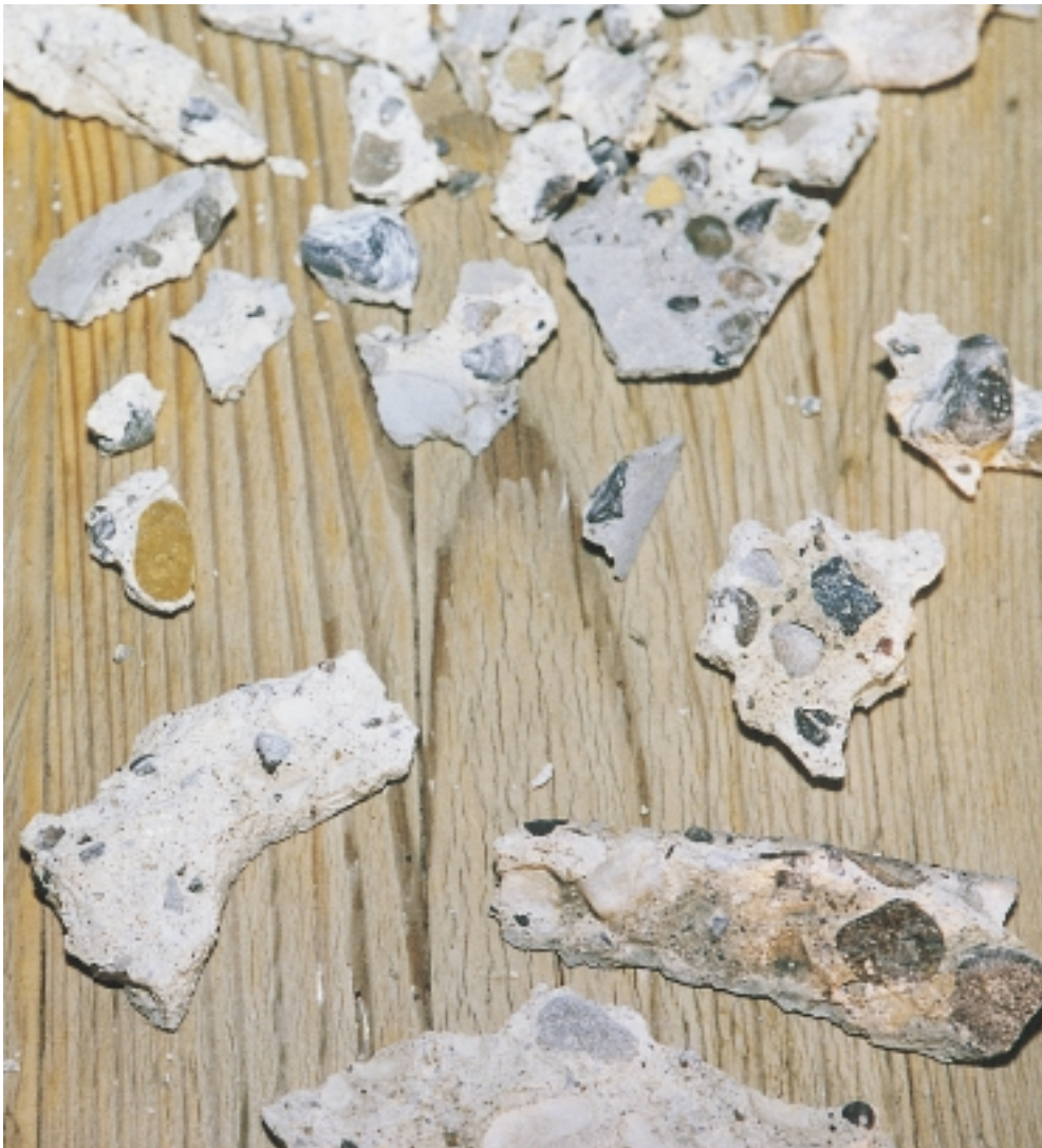
Abb. 2: Die Aufnahme zeigt Bruchstücke der zerstörten Partien. Der Bruch geht durch die Zuschlagstoffe.
