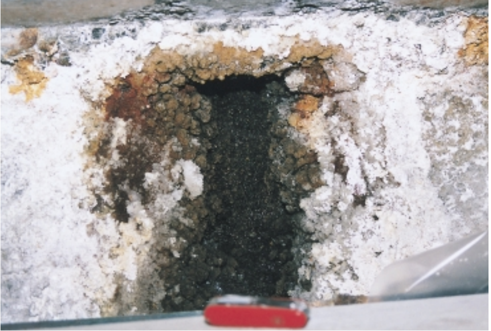
Abb. 5: In den Verdunstungszonen können sich die Wasserinhaltsstoffe anreichern, denen kein Beton «gewachsen» ist. Zudem genügt oft die Sprengwirkung der Salzkristalle, um Schäden zu verursachen.
