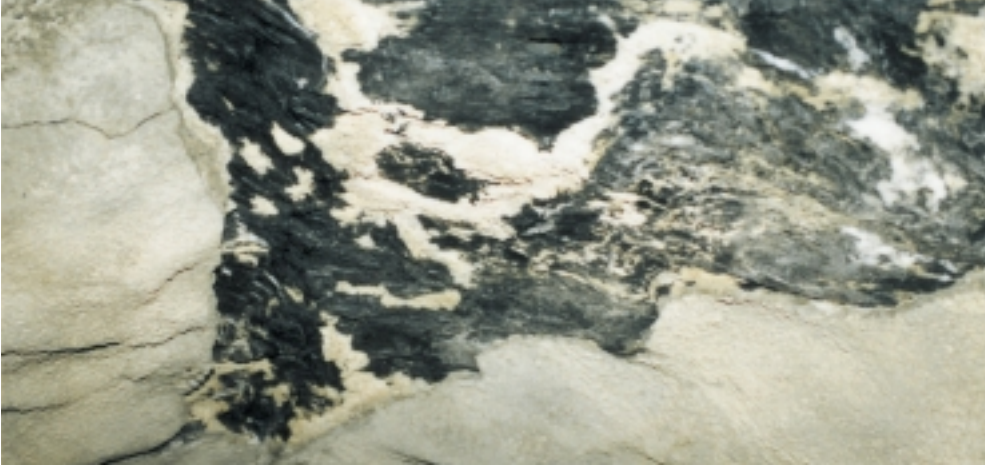
Abb. 4: Grossflächige Gunitabplatzungen im Gewölbe. Darunter Betonzersetzungsprodukte (Gips, Thaumasit...).
