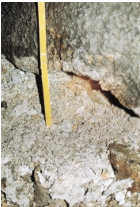
Abb. 7: km 1330: Natriumsulfatkristalle rieseln im entstandenen Hohlraum zwischen der Gunitschale und dem Natursteinmauerwerk herunter. Damit sich ein solches Schadensbild ausbilden kann, sind erhebliche Natriumkonzentrationen im Bergwasser erforderlich (Na > 100 mg/l).
