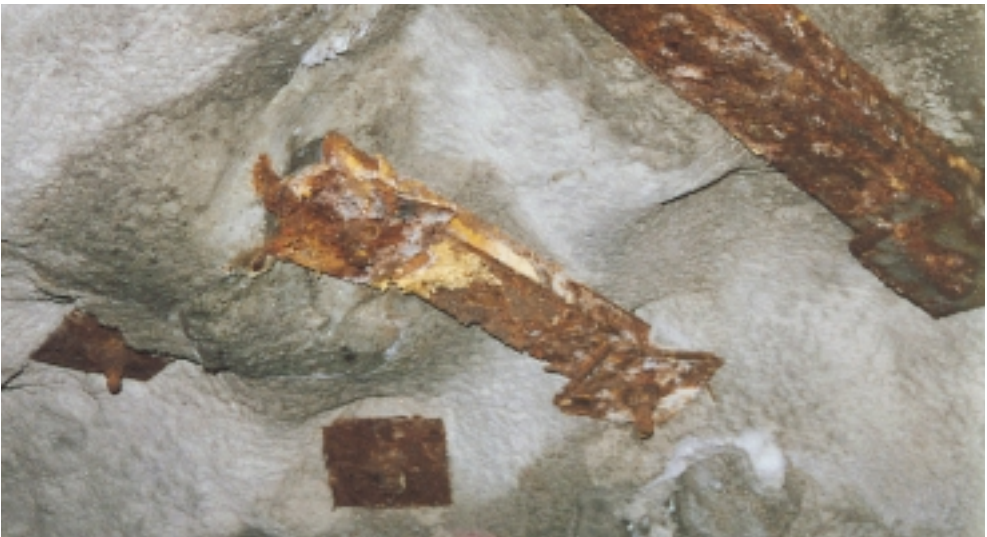
Abb. 8: Stark korrodierte Ankerplatte und Aufhängung.
