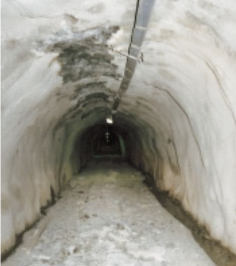
Abb. 6: km 4,850 ab Nordportal Korrosion der Spritzbetonschale im Sicherheitsstollen. Bildung von Ettringit und Thaumasil.
