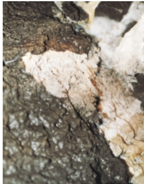
Abb. 4: km 1200: zerstörte Spritzbetonschale. Die Zersetzungsprodukte sind Thaumasit, Ettringit, Gips, Kalzit sowie Quarz in unterschiedlicher Zusammensetzung.
