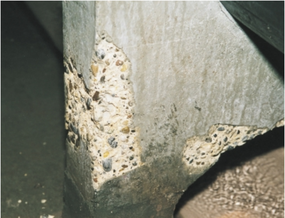
Abb. 1: Schalenförmiges Ablättern des Betons, zusätzlich bemerkt man eine leichte Braunfärbung des Zementsteins.
