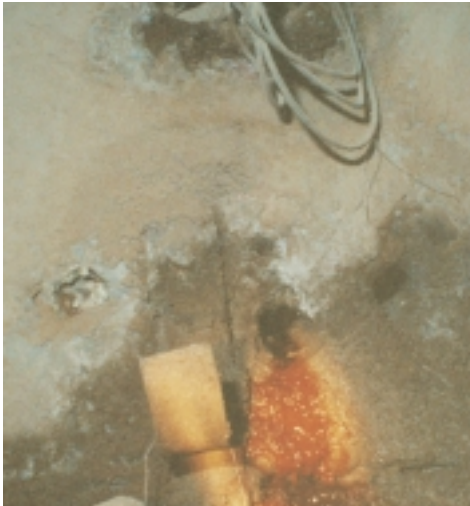
Abb. 4: N3 Bözbergtunnel Weströhre Extensometerkopf (Aufnahme 29.4.91). Tm 790. Resultat: Natriumsulfatausscheidungen mit wenig Kalk und 2% Chlorid. Bergwasser mit 4000 mg Sulfat, 3200 mg Chlorid und 3080 mg Natrium.
