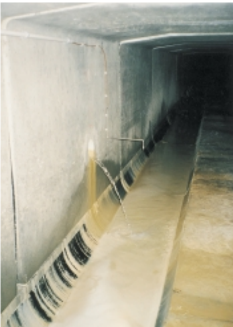
Starke Versinterungsbildung im SBB-Adlertunnel. Der ausgefallene Kalkschlamm ist weich, wird aber mit der Zeit hart.
