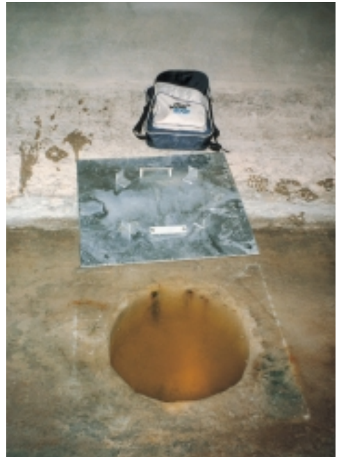
Versickerungsschacht im neuen Adlertunnel (Tagbaustrecke). Die Funktionstüchtigkeit geht bereits nach kurzer Zeit verloren.
