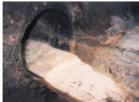
Abb. 6: Tiefendrainage Weströhre, Ablagerungsbildung in < 6 Monaten, die Kalkmilch (eine direkte Folge der Abb. 4) verursacht 20 cm starke, weisse Ablagerungen.
