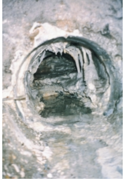
Ablagerung im Belchentunnel durch Kalkmilch.
