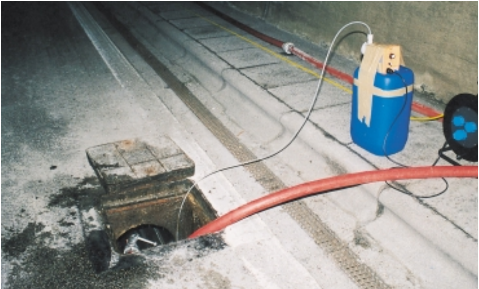
Abb. 11: Einspeisung von Zugabewasser (FW-Schlauch) und Markierstoff (Dosierpumpe) in die Entwässerungsleitung des Belchentunnels.
