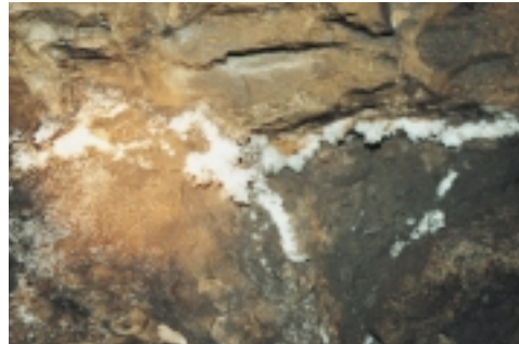
Abb. 7: Durch die Wasserverdunstung an der Fugenoberfläche reichern sich die Wasserinhaltsstoffe an und kristallisieren als Salze aus, wobei deren Druckkräfte die Mörtelfestigkeiten weit übersteigen.
