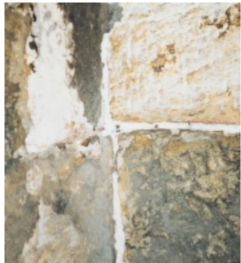
Abb. 11: Die Fugen zwischen den grossen Natursteinquadern sind wegerodiert. An ihre Stelle sind Mineralsalze getreten. Befinden sich die entsprechenden Steine im Gewölbe, droht der «Absturz» (Bsp. SBB-Bözbergtunnel) einzelner Bruchpartien.
